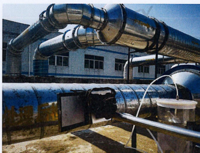
移印废气处理后采样口
