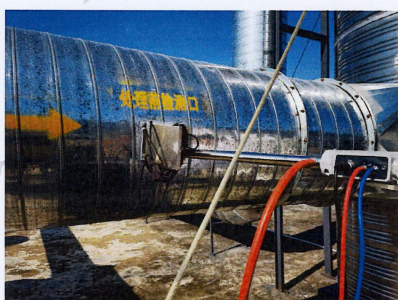
打磨、切割废气处理前采样口
