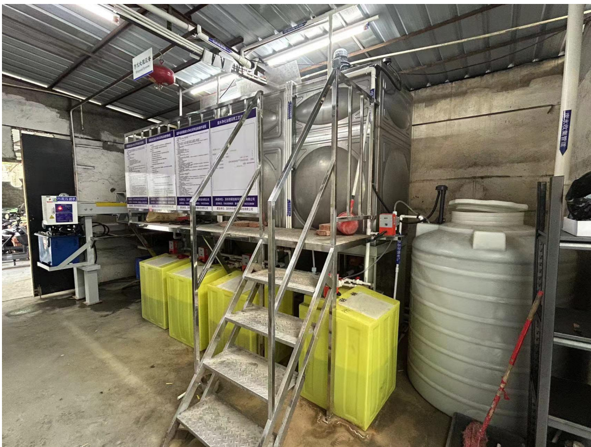
工业废水：废水净化处理回用装置
