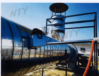
打磨、切割废气处理后采样口
