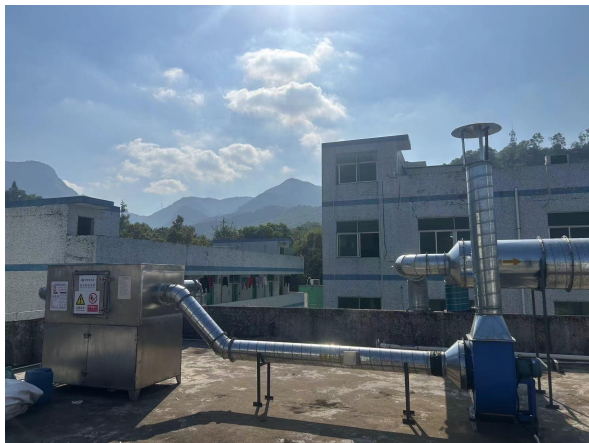
移印废气：高效蜂窝活性炭吸附装置
