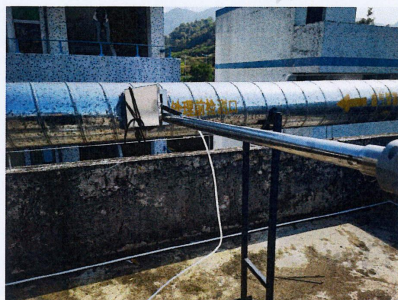
移印废气处理前采样口
